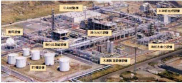
図2 瀝青炭液化技術（NEDOL法）プロセスパイロットプラント
